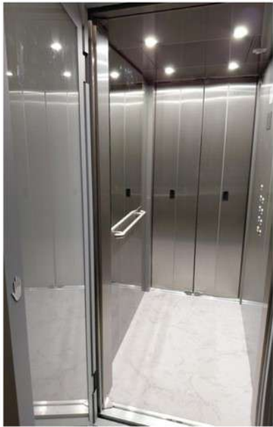
Vgradno dvigalo v ulici Milčinskega 4 stanovanjci že uporabljajo.
